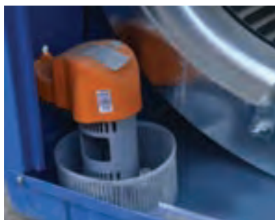
صافی آب و پمپ
