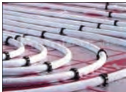
لوله کشی با لوله های ترموپلاستیک
